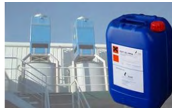
Tratamiento de agua
